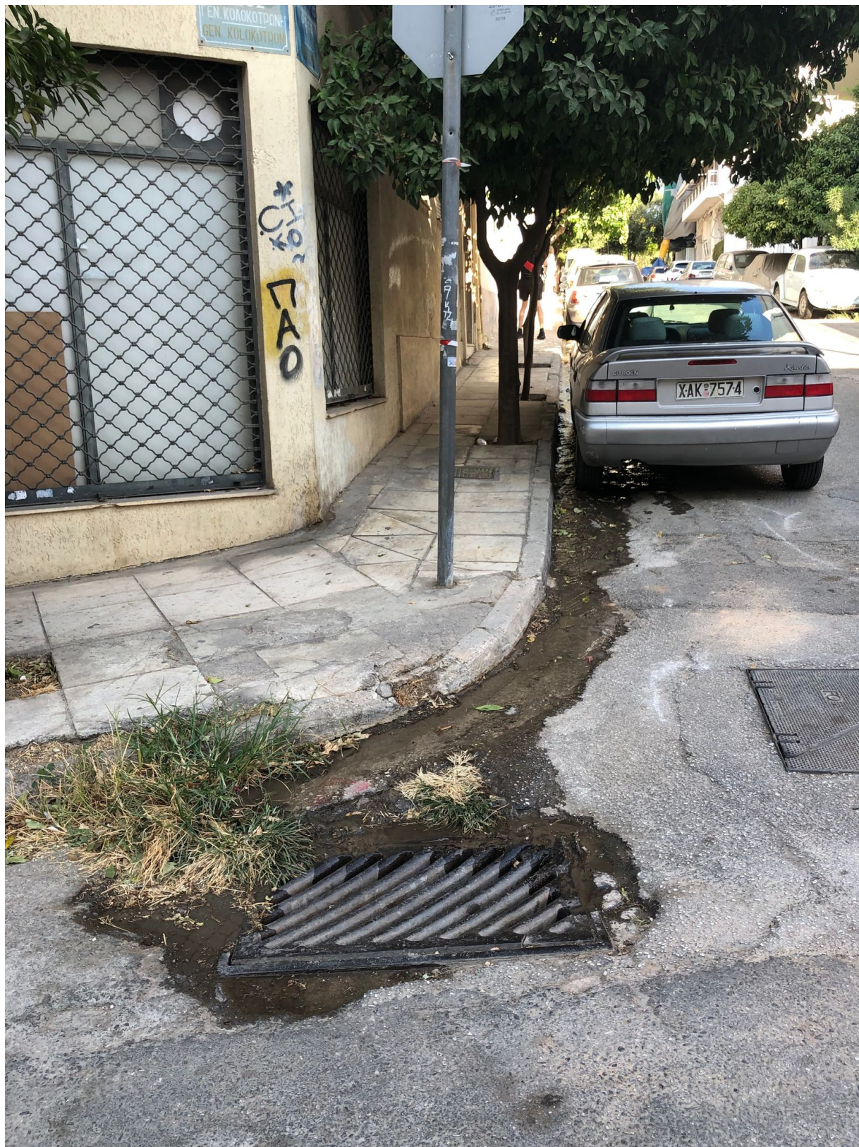
Po ulici stékající kondenzovaná voda z klimatizace, nebo něco jiného? Archiv autorů.
